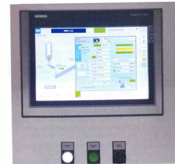
Fig. 3. BHS-Sonthofen not only provided the machine, but also the control solution for the entire system. Bild 3. BHS-Sonthofen lieferte nicht nur die Maschine, sondern auch die Steuerungslösung für die komplette Anlage. Photo/Foto: BHS
