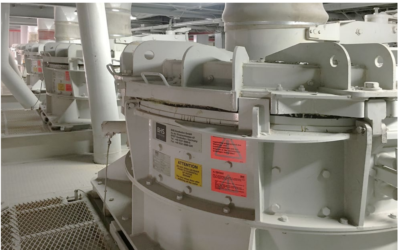
五台 RPM 1513 型 BHS 转子冲击式破碎机正在一家位于泰国的干砂浆厂内工作
